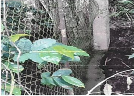
Foto 3: Reparacion de muro perimetral con 3 hiladas de block , mayo y tubo galvanizado con soleras y columnas ✓
